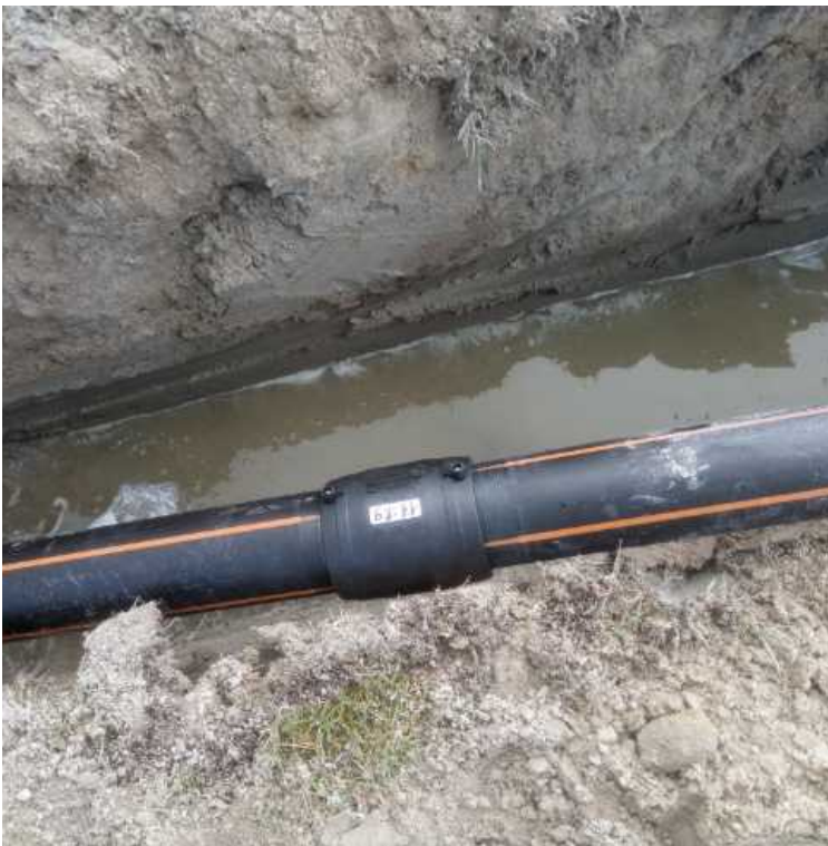
Figure 17. Vue de la conduite d'assainissement et du système de raccord (soudure par chauffage de résistances)
