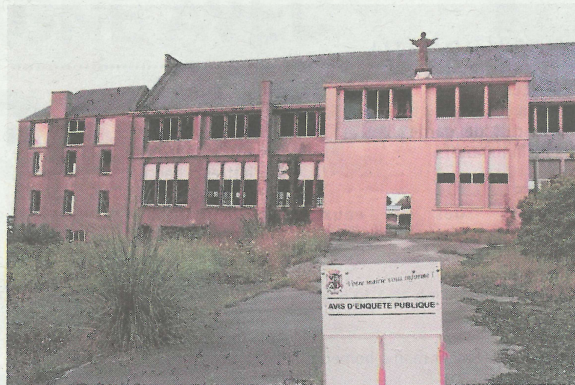
Accessible sans difficultés, insalubre et dangereux, le site de l'ancienne école du Sacré-Coeur, Skol-an-Aod, est en état d'abandon manifeste.
