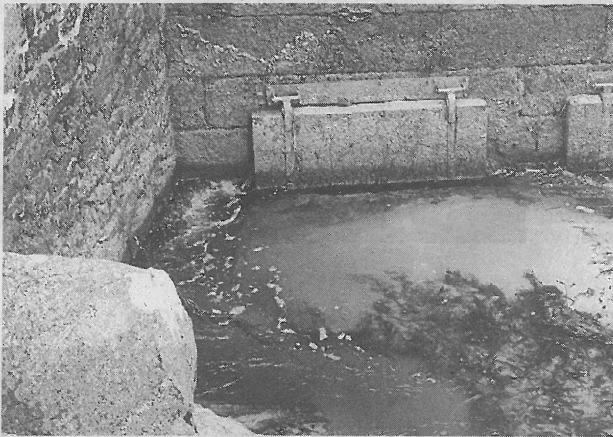
Les vannes de l'écluse sont régulièrement bloquées.
